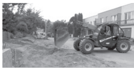
Zahájení budování chodníku ve spodní části ulice V Sadech po rekonstrukci vodovodního řadu.
