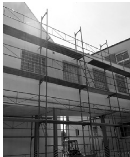
Zahájení prací na výměně luxferů za okna ve spojovacím krčku školních budov.
